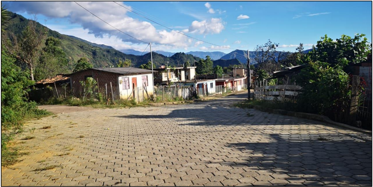
Imagen 43 Capa de rodadura de la red vial del Centro Urbano de El Airo
